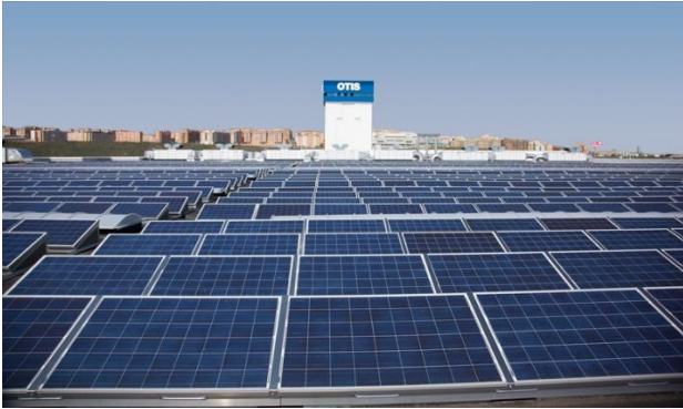
FÁBRICA OTIS Y OTROS EDIFICIOS INSTALACIONES FOTOVOLTAICAS DE CUBIERTA Y CERTIFICACIÓN LEED
