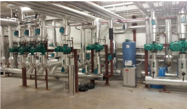
EDIFICIO IMDEA ENERGIA MOSTOLES (MADRID)
