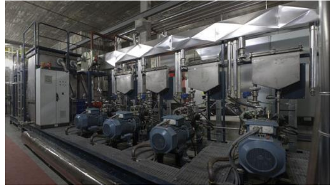
EDIFICIO LUCIA DE LA UNIVERSIDAD DE VALLADOLID INSTALACIÓN DE TRIGENERACIÓN 100 kWe 180 kWt ALIMENTADA POR ASTILLA DE MADERA
