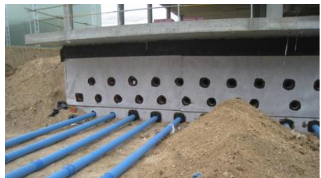
EDIFICIO LUCIA DE LA UNIVERSIDAD DE VALLADOLID INSTALACIÓN DE POZOS CANADIENSES
